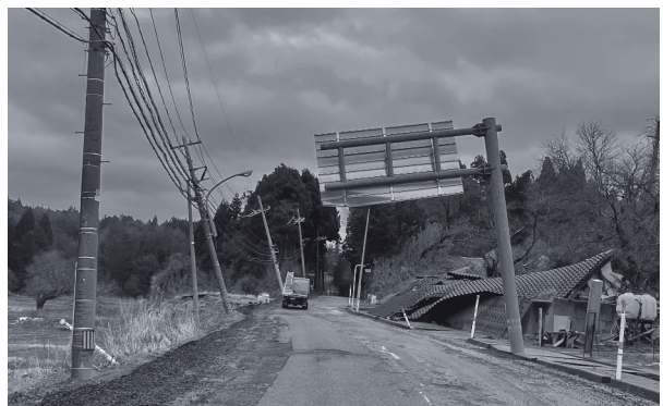
写真1 能登半島地震では、道路の寸断や断水などで、いくつもの集落が孤立した
