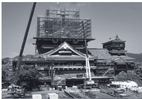
写真3 復旧作業中の天守閣。熊本城は震災復興のシンボルとして最優先で復旧作業が進められた
