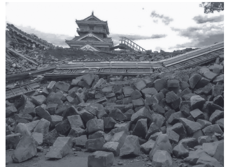
写真2 被災した熊本城宇土櫓(うとやぐら)。宇土櫓は、築城当時の姿を保っている多重櫓で国指定重要文化財。南側の続櫓(つづきやぐら)が倒壊した
