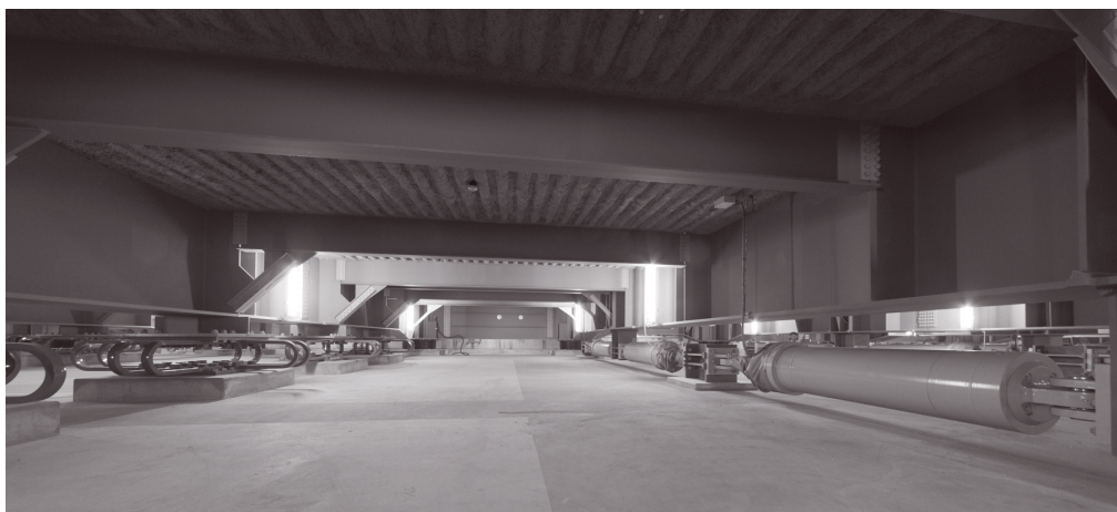
中間免震装置
